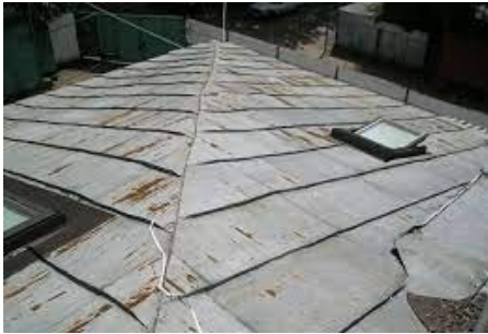
Рис. 4.1. Загальний вигляд покриття з покрівельної сталі, пошкодженого корозією
