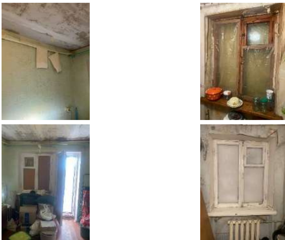
Рис. 3. Об'єкт відновлення м. Краматорськ. Вулиця Академічна, буд.66, кв. XXX, Категорія А
