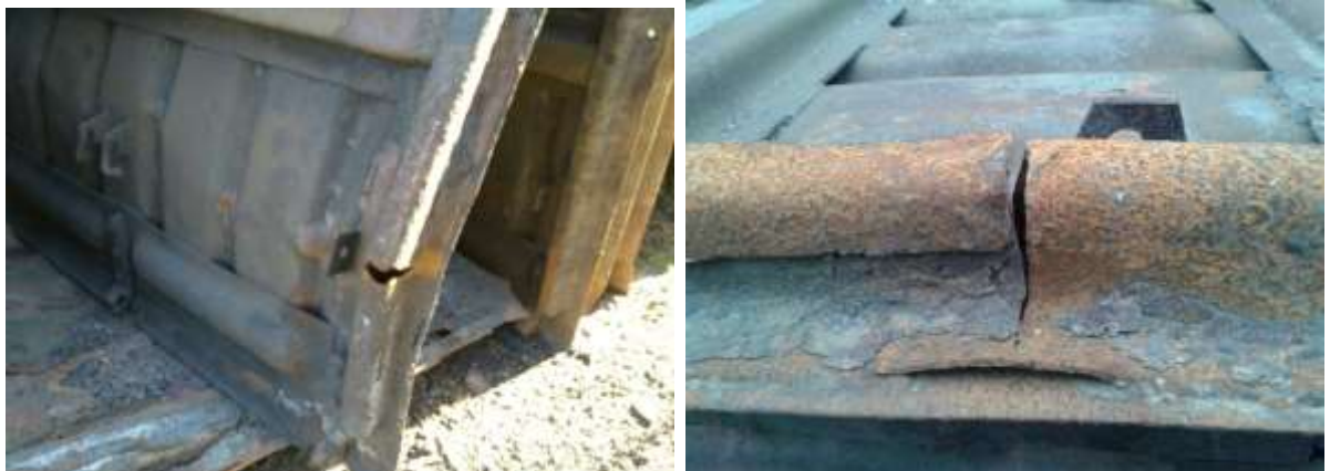
Рисунок 2.20 – Пошкодження бокового обв'язування типової конструкції кришки люка
