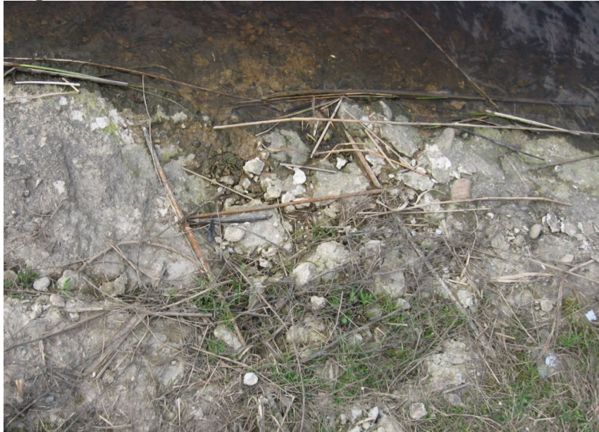
Рис. 3 – Повреждение напорного фронта сооружения ветро-волновым воздействием
