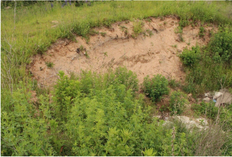
Рис. 2 – Повреждение напорного фронта сооружения ветро-волновым воздействием
