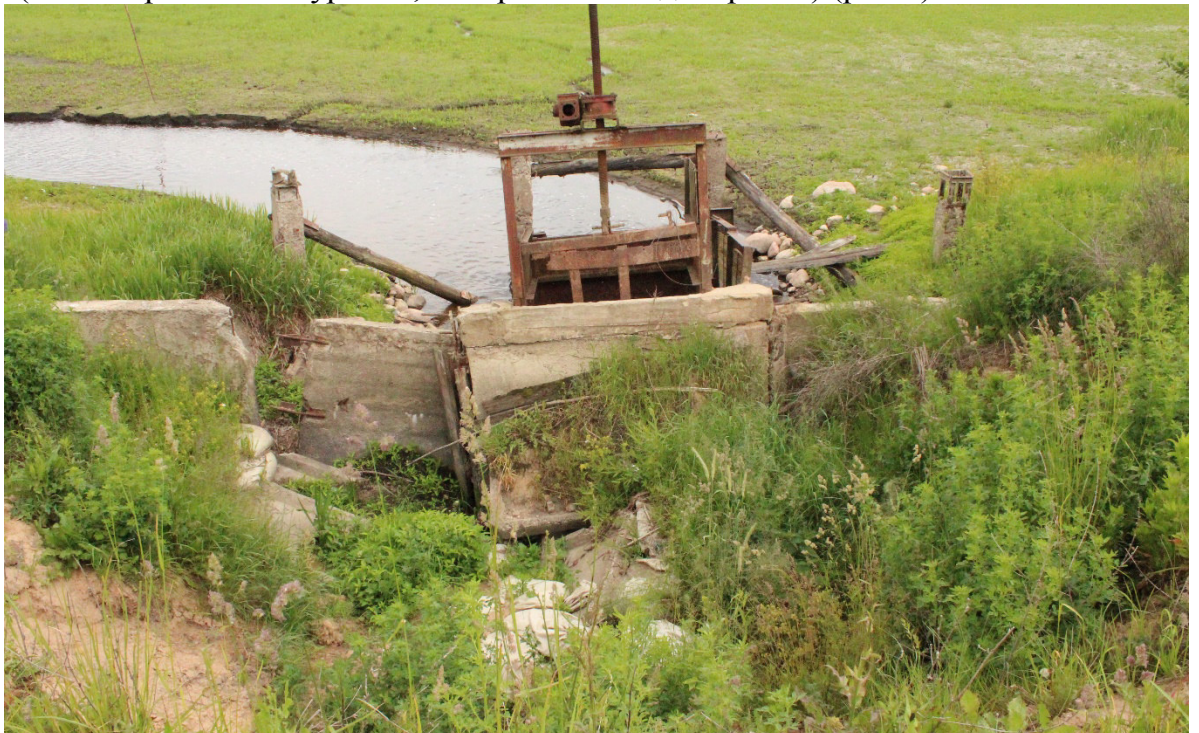
Рис. 4 – Разрушение регулирующего устройства напорного фронта сооружения
