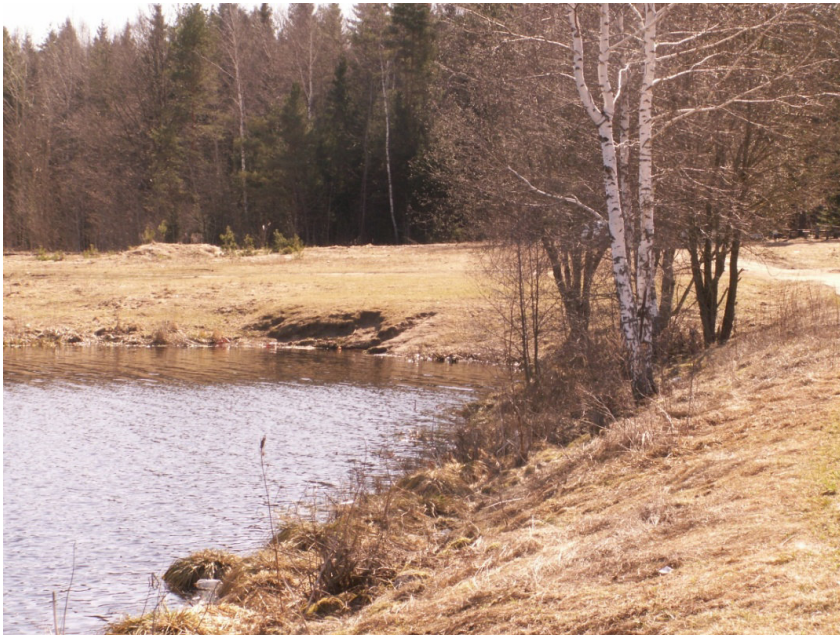
Рис. 3 – Эрозия напорного фронта сооружения
