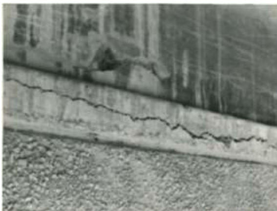
Рис. 8.3.2. Зруйнований монолітний бетон житлового будинку
