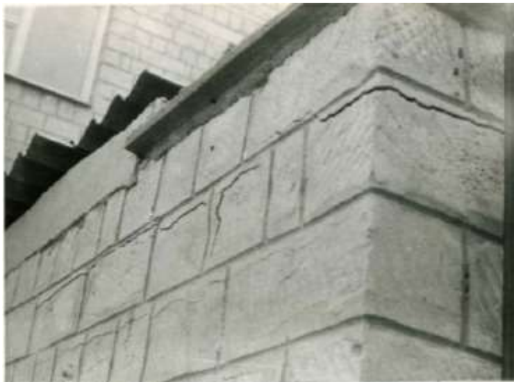
Рис. 8.3.1. Руйнування розчину в швах кладки будівлі
