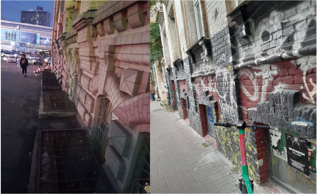
Рис. 1. Фото занедбаних напівпідвальних приміщень історичних будівель м. Києва
