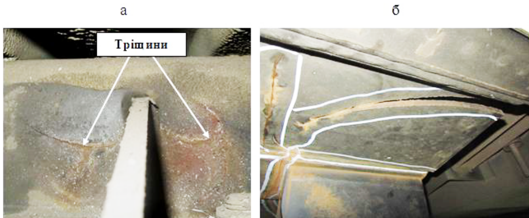
Рис. 3.7. Приклади руйнування вертикального (а) і горизонтального (б) листів шворневої балки в районі кріплення ГКВ
