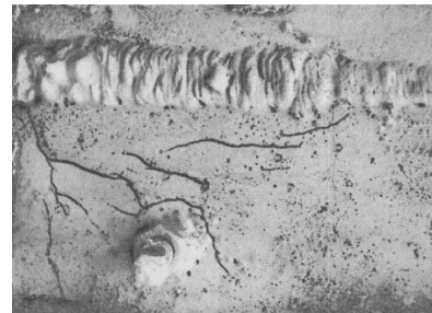
Рис. 14. Тріщини на внутрішній поверхні реактору каталітичного окиснення аміаку
