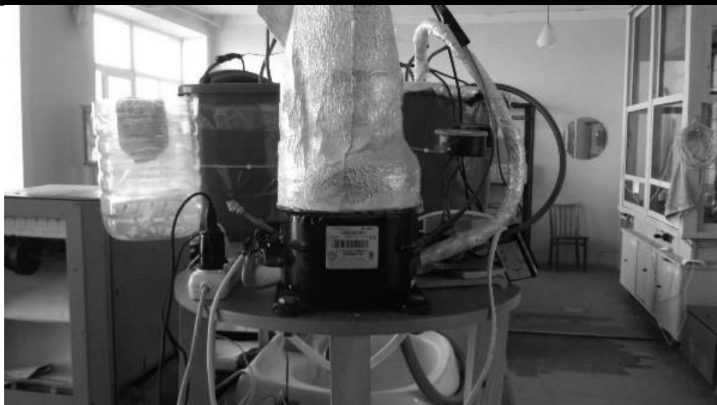
Рис.1 – Лабораторная теплонасосная установка
