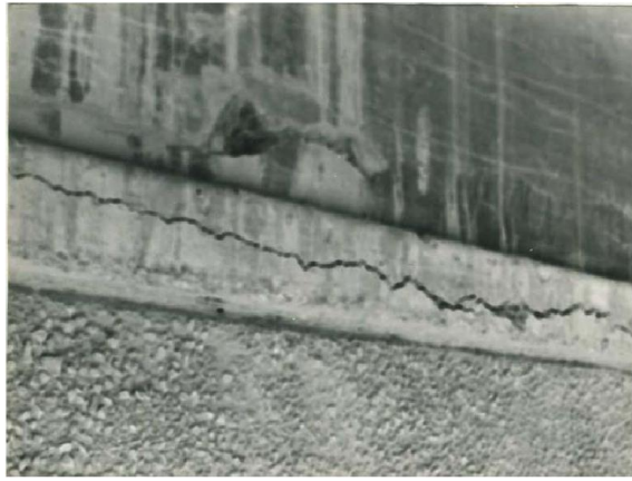
Рис. 8.3.2. Зруйнований монолітний бетон житлового будинку
