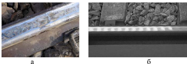
Рис. 1. Виды дефектов рельсов из-за чрезмерной подачи песка: а – дефект № 14; б – дефект № 40
